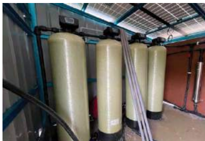
JAKOA Project of Ultrafiltration
